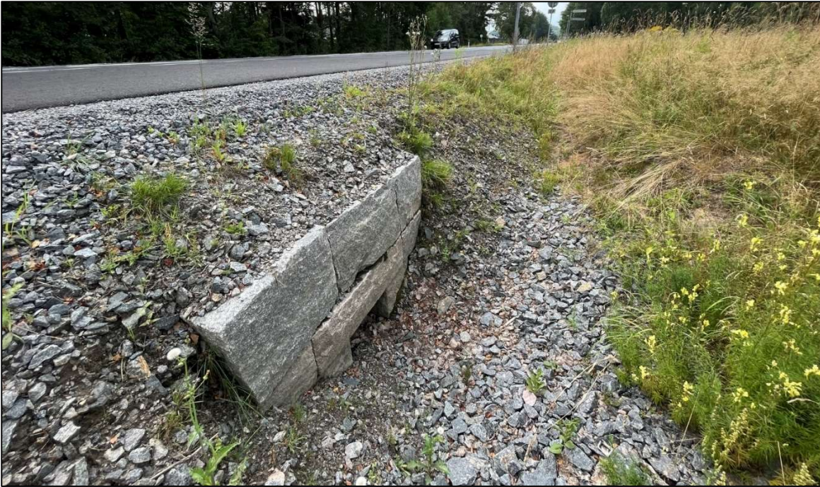
Figur 19. Dagvattentrumba under vägen (Foto Norconsult).
