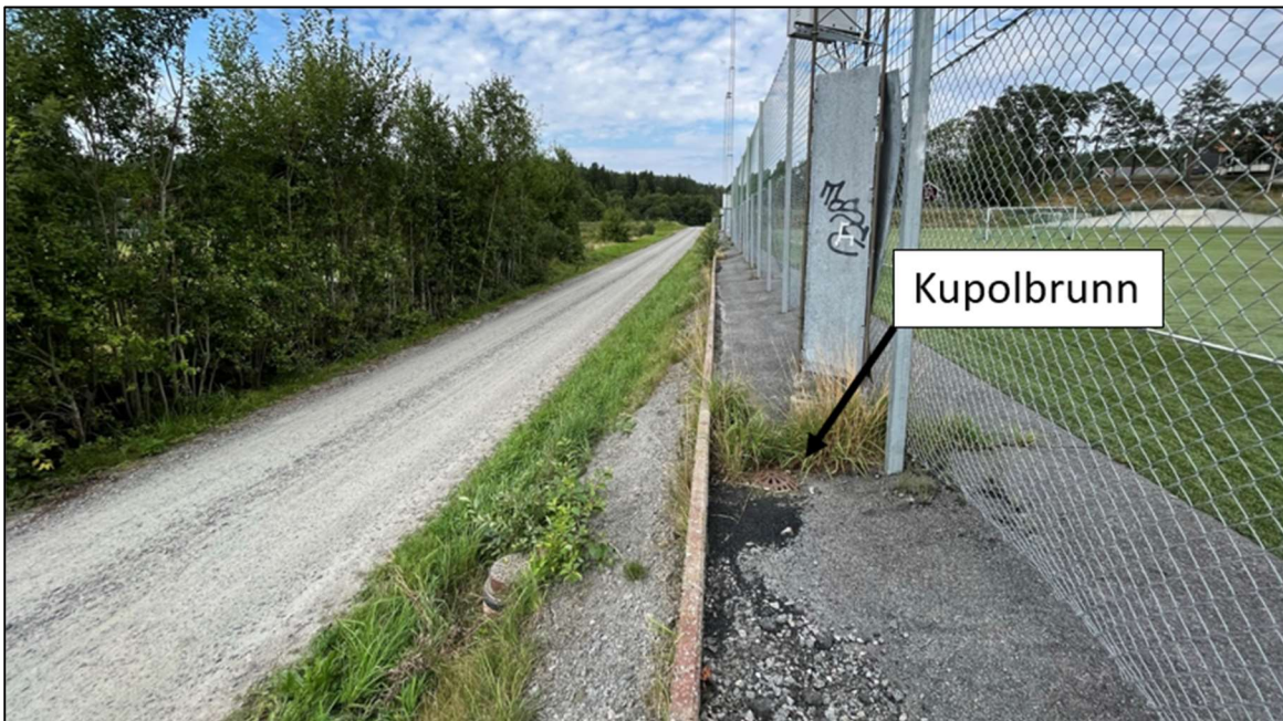
Figur 20. Konstgräsplanen avvattnas via kupolbrunnar.
