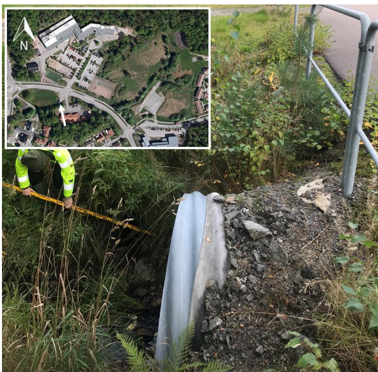
Figur 6. Dimension på trummor i befintligt dike längs Kvarnbacken söder om planområdet (Ramboll, 2020).
