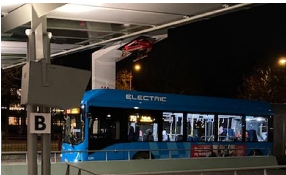
Figur 12: Laddning för elbussar installerades på Mölnlycke resecentra under 2020.
