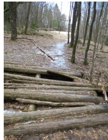
Stigen norr om Agntjärn behöver rustas upp.
