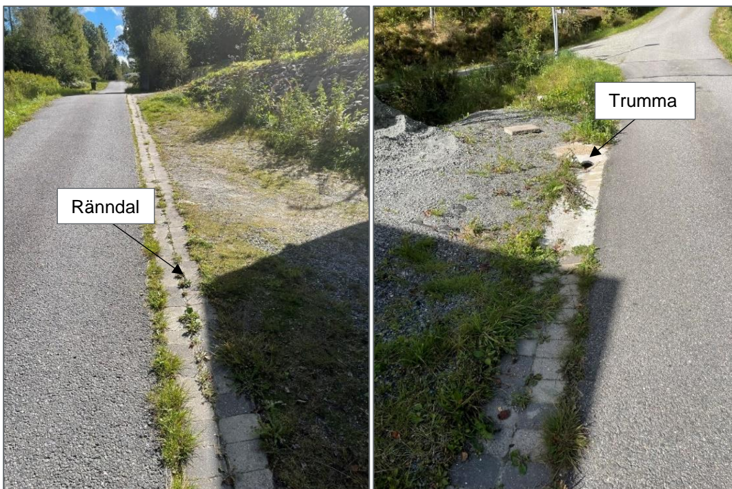
Figur 20. Rännal och trumma längs Ärlevägen för styrd avledning mot Skällsjön. (Foto: Norconsult)
