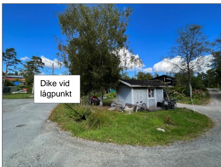
Figur 18. Dike vid lågpunkt längs södra delar av Rödhakevägen. Ingen trumma noterades här under platsbesöket (Foto: Norconsult)
