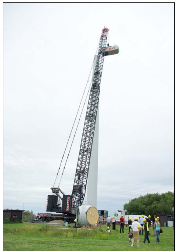
Figur 6. Pågående byggnation av två verk med totalhöjden 125 meter i Axeltofta, Landskrona kommun.
