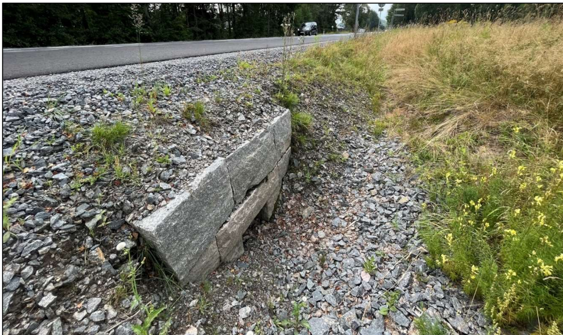
Figur 14. Dagvattentrumma under vägen (Foto Norconsult).
